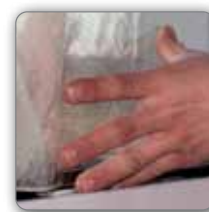
Verklebung unter Fensterleisten
