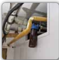
Anpassung an Kellerverteilungen
