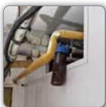
Přizpůsobení rozvodům ve sklepě
